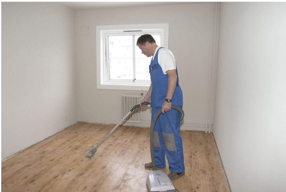
3. Skader i gulvet må utbedres før liming og legging.
