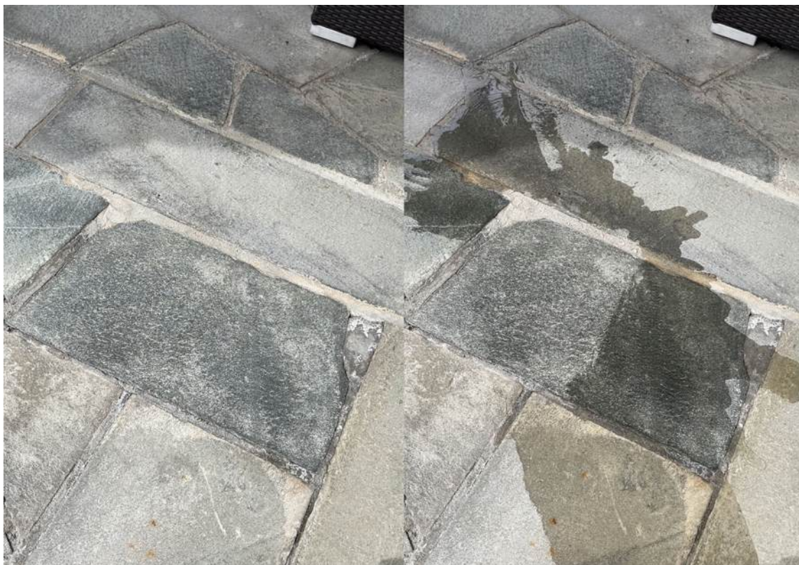
STOR FORSKJELL: Disse steinhellene hadde godt av å bli impregnert. Når det kastes en bøtte med vann, ser man tydelig hvor impregneringsvæsken har vært penslet på.
