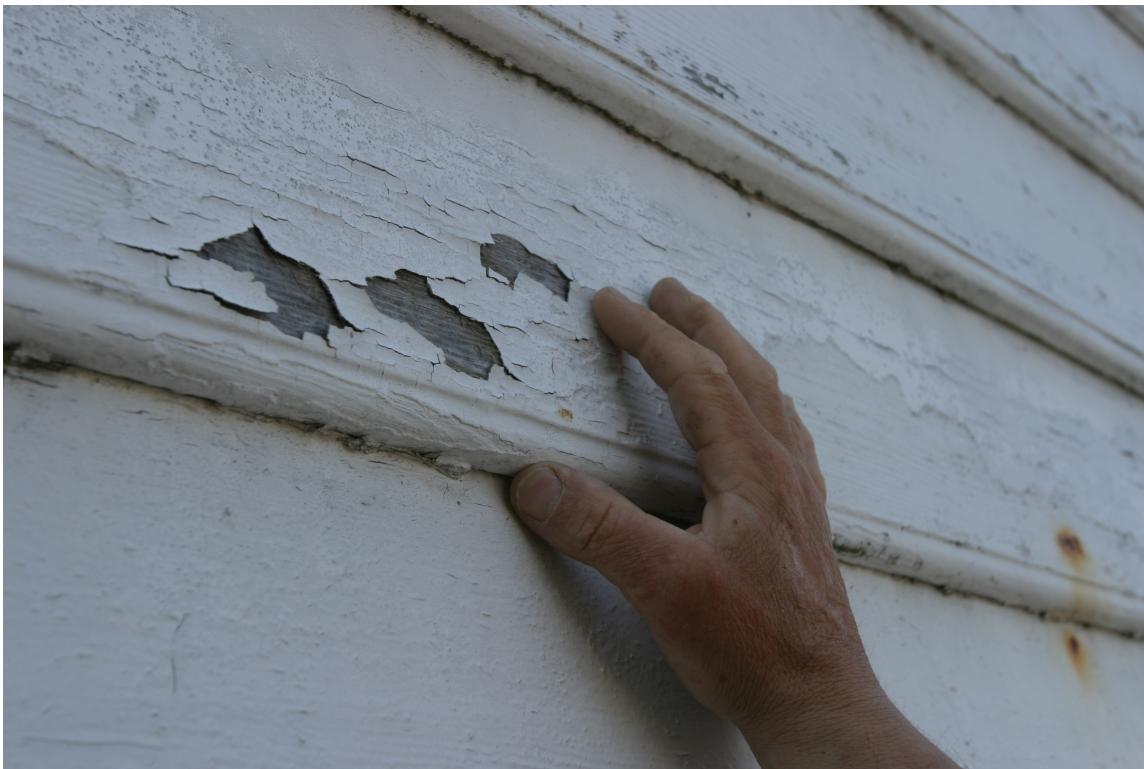
FLASSER: Flassende maling og bart treverk betyr at overflaten ikke lenger gir tilstrekkelig beskyttelse mot fukt og værbelastning.
