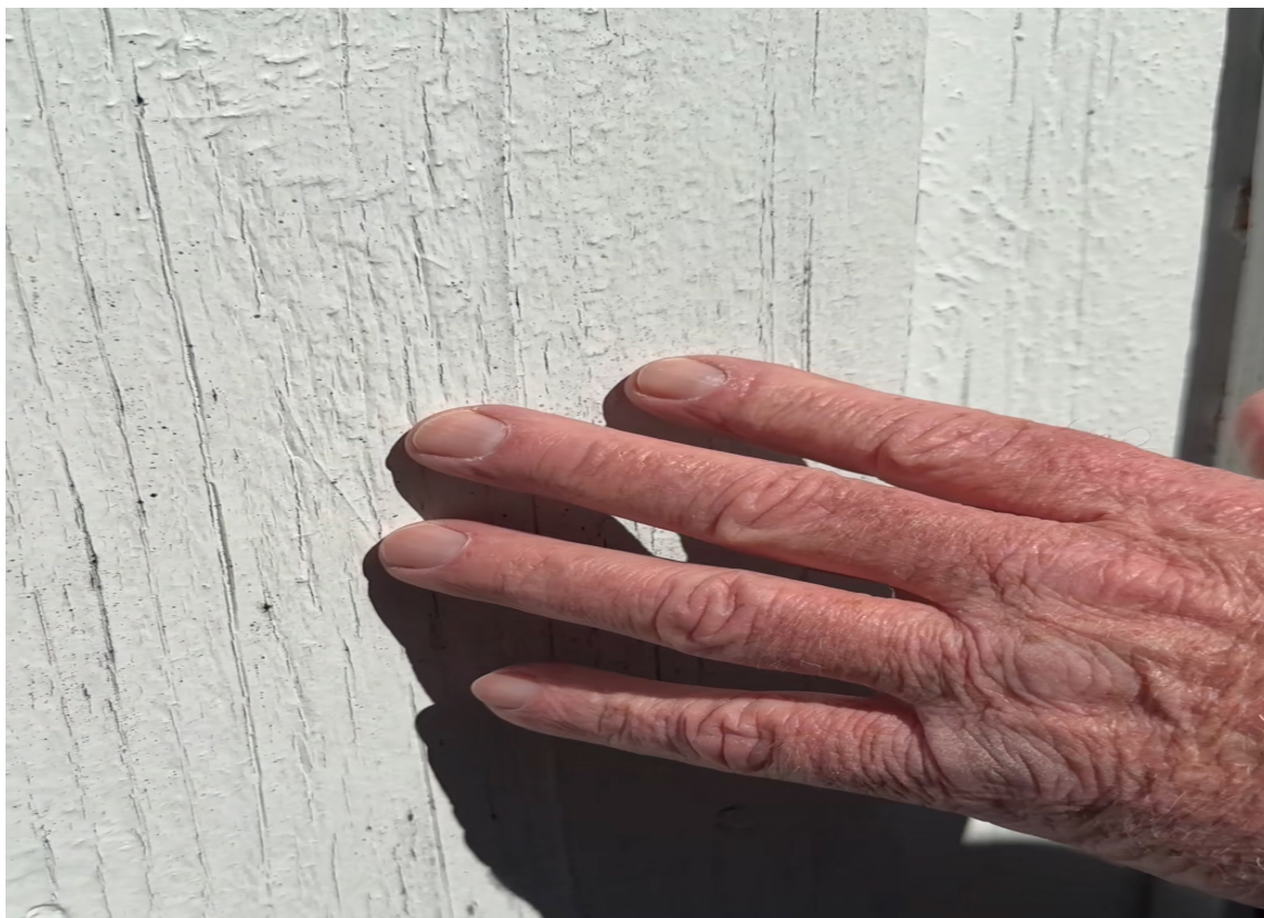
BEGROING: Mose, grønnalger og svertesopp holder på fuktigheten over tid og kan føre til økt slitasje og skadeutvikling på kledningen.
