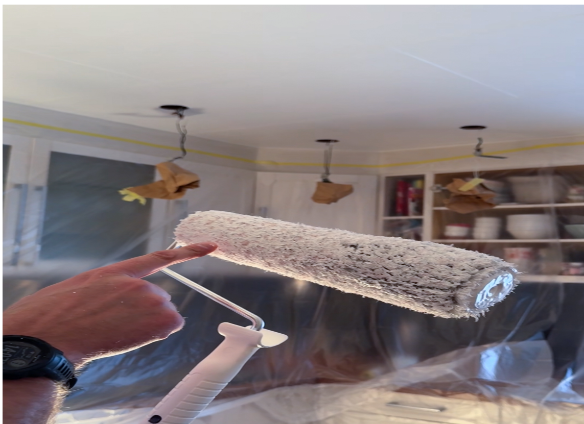
FOR MYE KRAFT: Unngå å presse rullen. En flatklemt rull gir ujevn påføring og mindre maling på veggen. La rullen gjøre jobben. Her er et eksempel på hvordan rullen ikke bør se ut.
