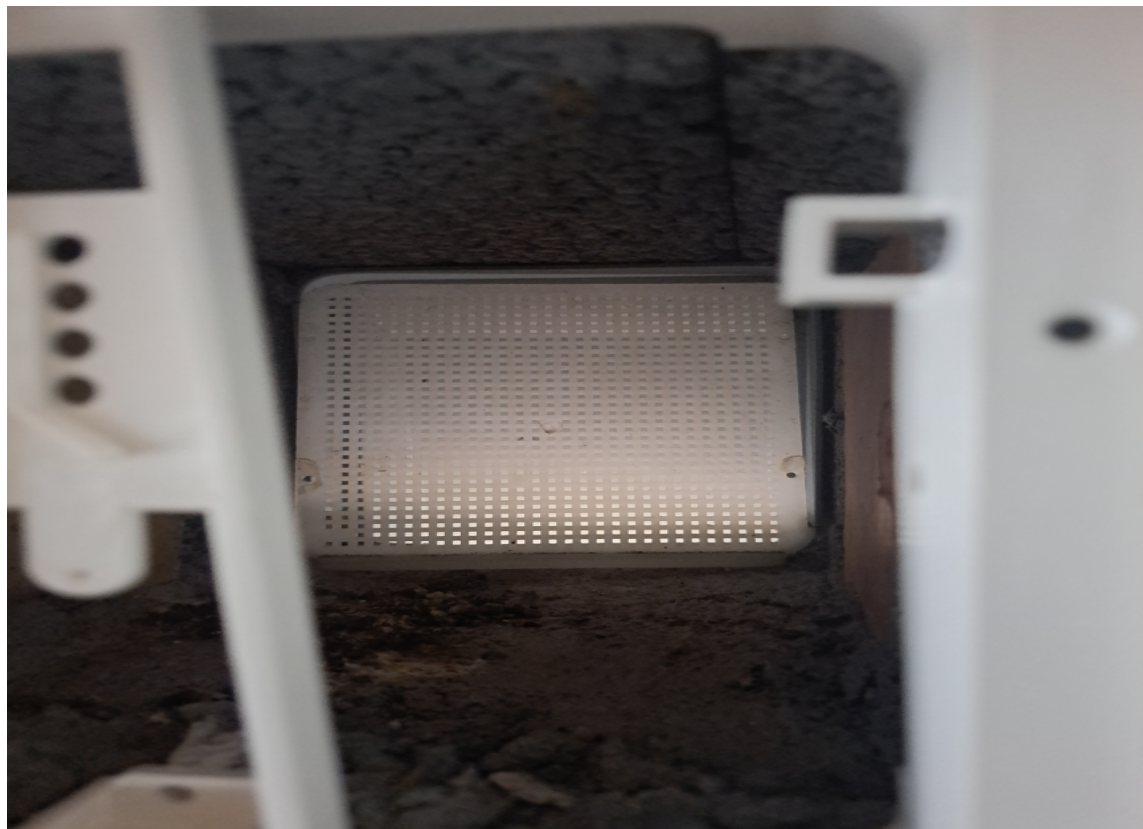
SJEKK VENTILER: Mus finner veien gjennom de minste åpninger. Sørg for at nettingen i ventilen er hel, så slipper du små gjester inn i vegg
