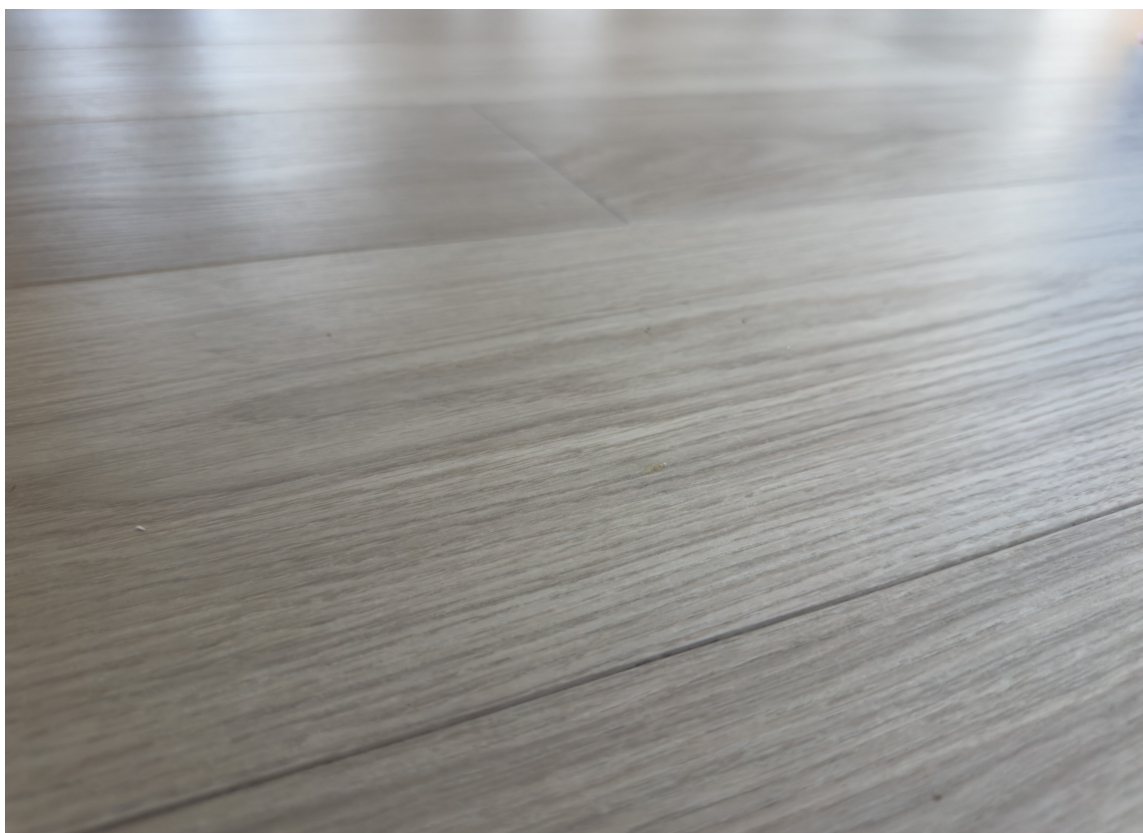
ETTER: Etter reparasjonen er skaden nesten helt borte, og gulvet ser ut som nytt.
