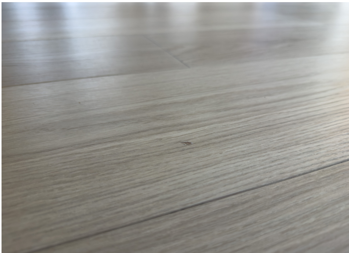
FØR: Et skarpt hakk i gulvet – trolig fra en kniv eller gjenstand som har falt ned.
