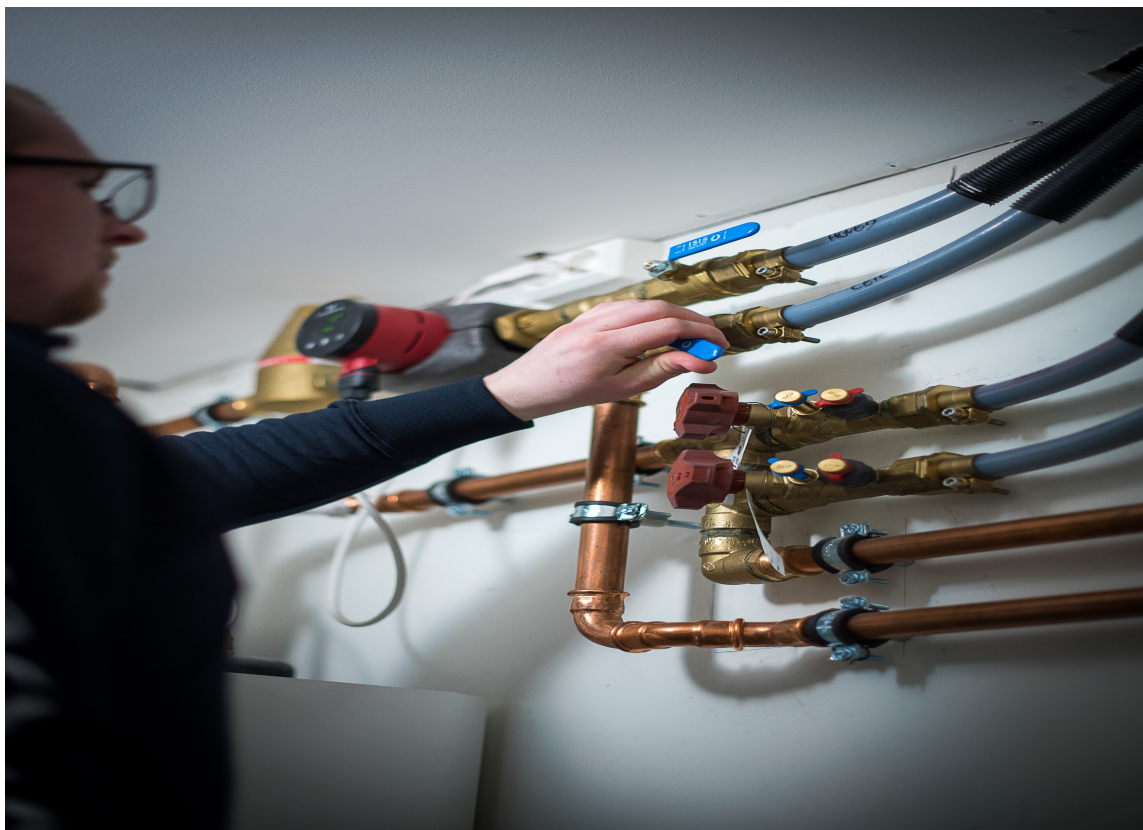
TEKNISK ROM: En klassiker er at noen i et borettslag glemmer et vindu på gløtt, så det trekker kald luft inn i tekniske rom.
