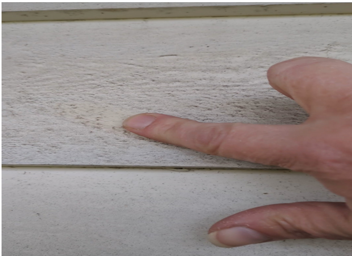
VASK: Her er fasaden såpass skitten at den bør vaskes med en kraftvask.
