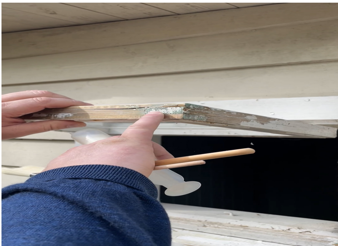
FINGERSKJØTER: Fingerskjøtene på et vindu er et veldig utsatt område, og kan være vanskelig å behandle.
