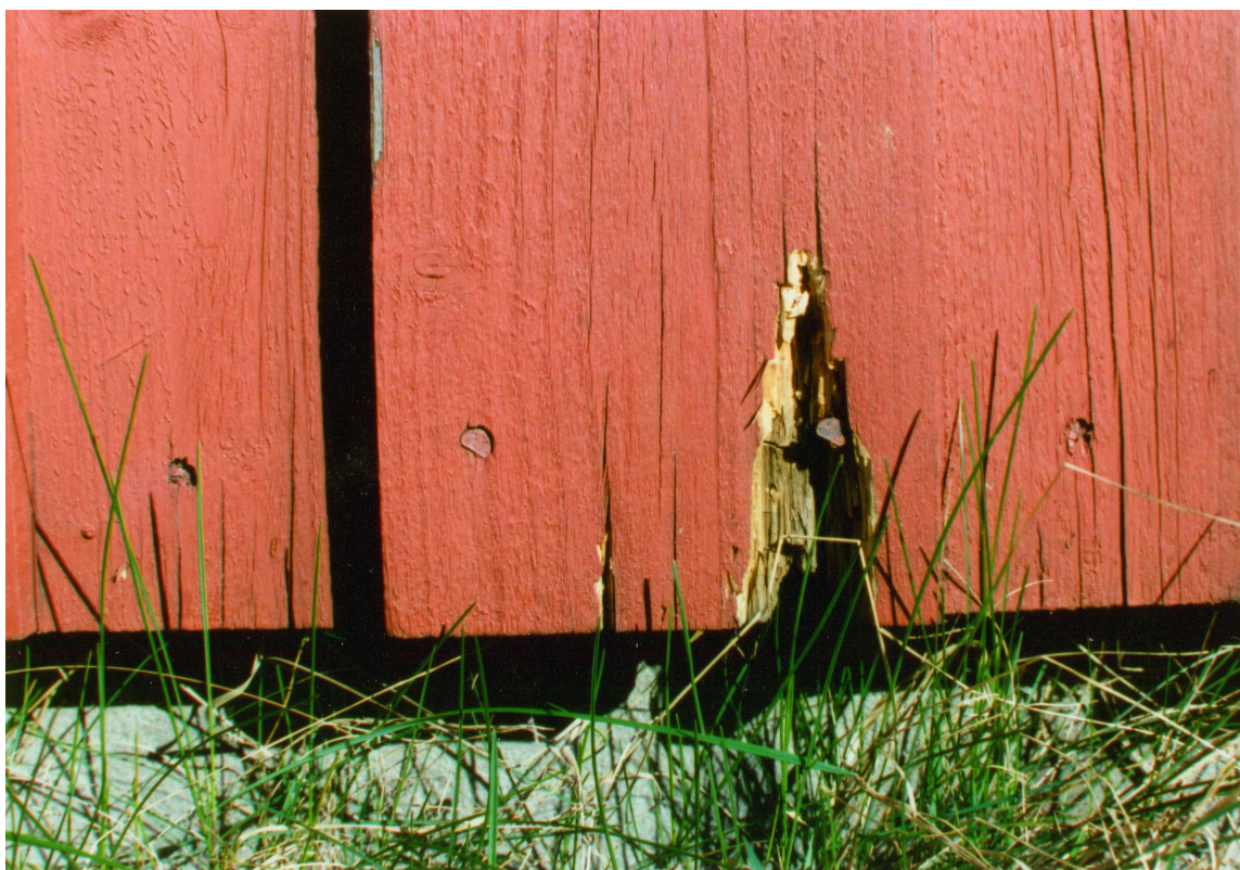
RÅTE: Her har det gått galt på grunn av manglende grunning av endeveden, og skaden skjer fort.
