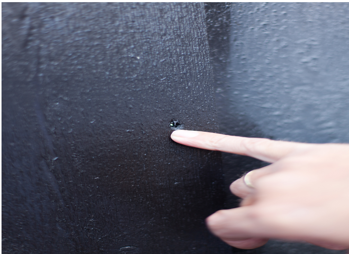
SPIKERHULL: Et eksempel der det er brukt for mye kraft. Her trenger vann inn.
