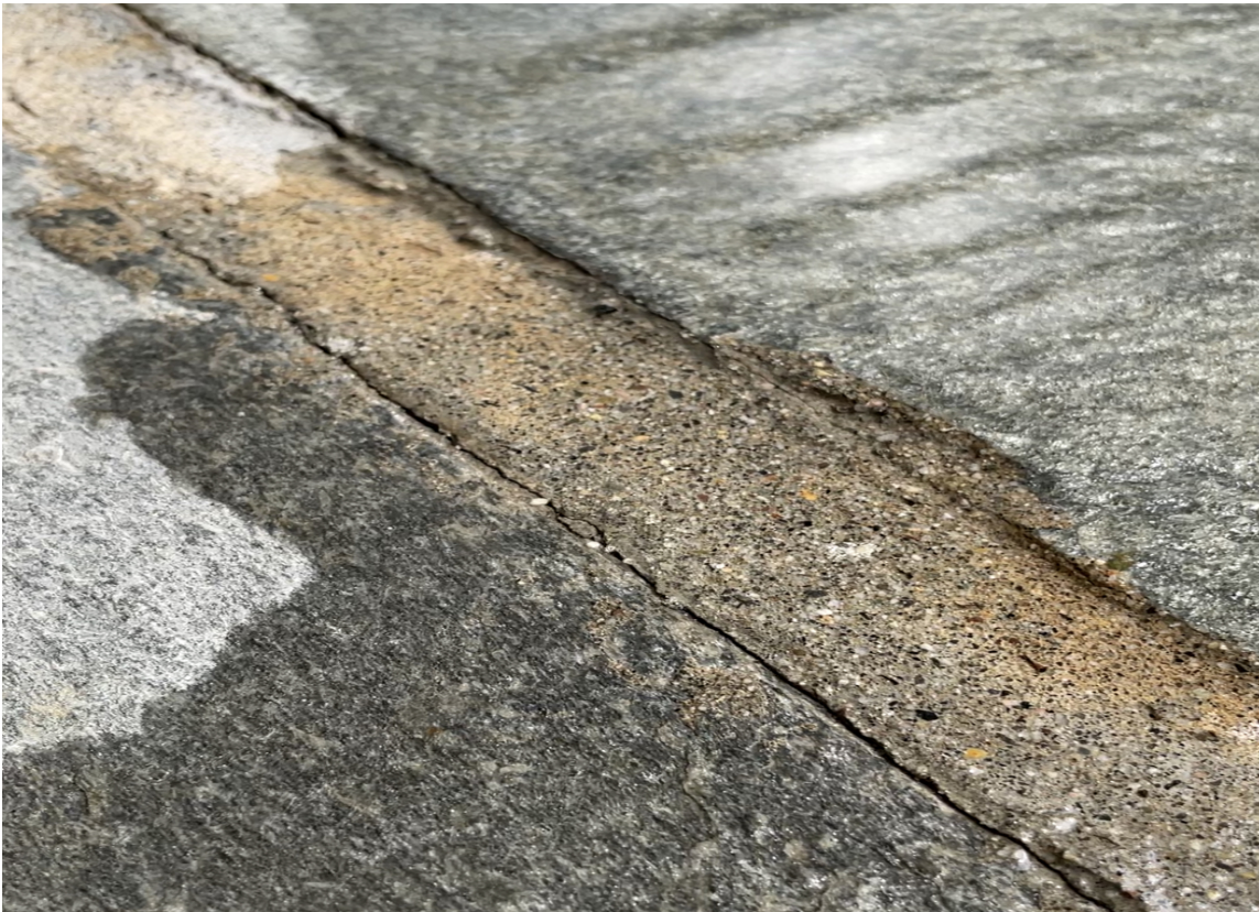
BLØT FUG: Her har fugene ikke fått impregnering på seg, og vi ser hvordan vannet har trukket ned.
