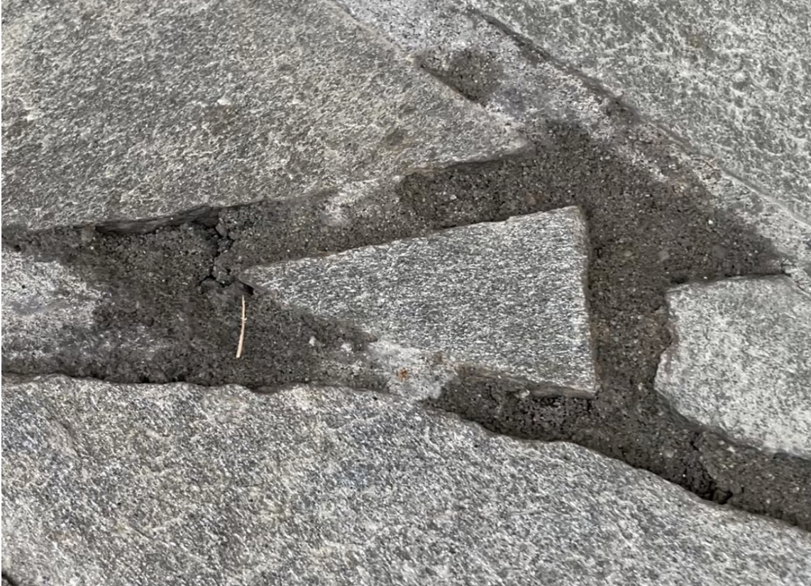
ØDELAGT: Her ser vi en ødelagt fuger som har blitt frostsprengt. Denne fugen ble vasket 24 timer tidligere, og har ennå ikke tørket til tross for gode solforhold.
