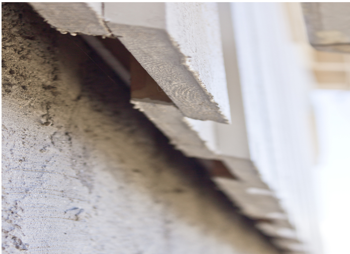
UTSATT: Vegger mot nord er mer utsatt for begroing, mens malingen på vegger mot sør- og øst slites mer.
