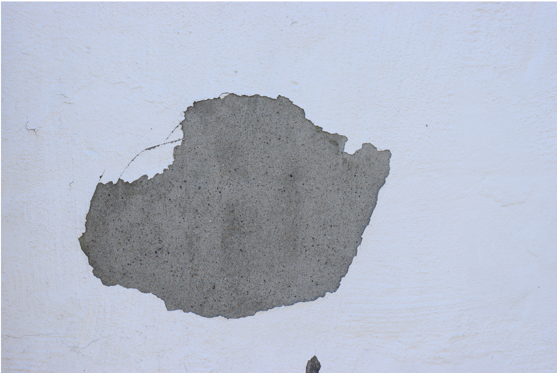
GRUNNMUR: Sjekk at grunnmuren ikke har sprekker og at den er fri for sopp og alger, avskalling, setningsskader, vanninntrenging og saltutslag.
