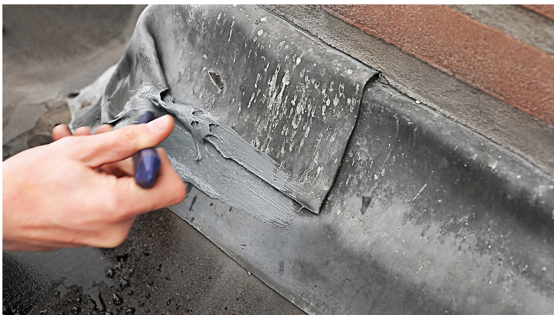
VEDLIKEHOLD: Det finnes mange midler som reparerer sprekker og skader i takrenner og nedløpsrør.
