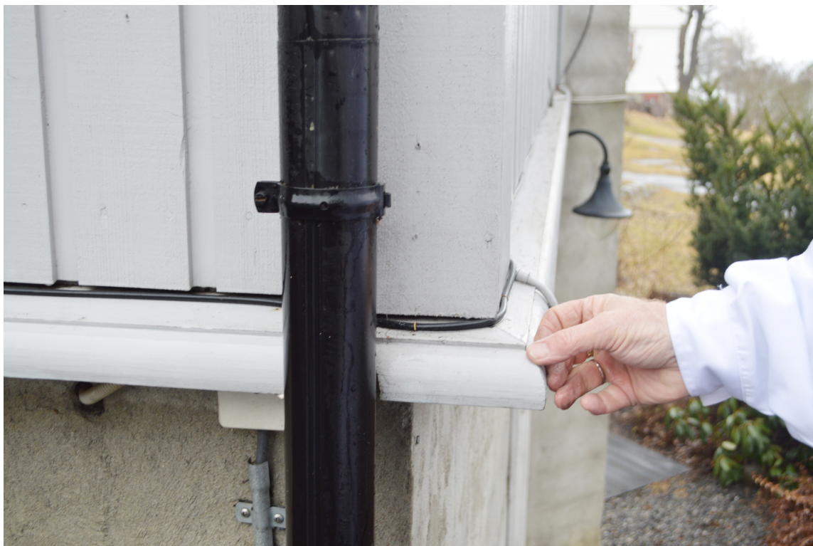
SJEKK NEDLØPSRØR: Sjekk om nedløpsrørene er blokkerte eller skadet.
