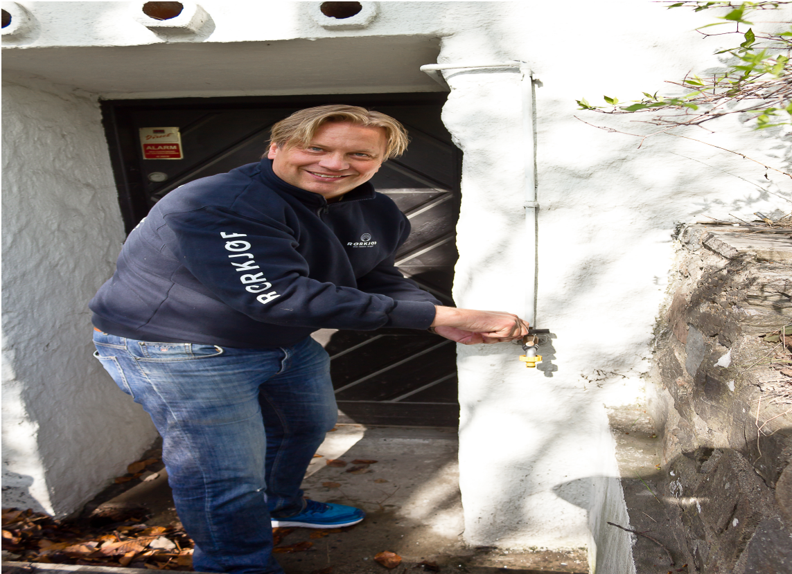
UTEKRANA: Hussjekken er den perfekte anledningen for å se om utekrana trengs å byttes ut eller få litt service .
