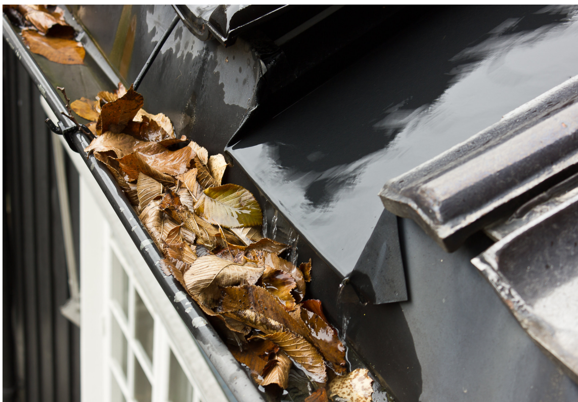
TAKRENNNA: Ser takrenna di slik ut, bør du rense den godt, så vannet slipper gjennom.
