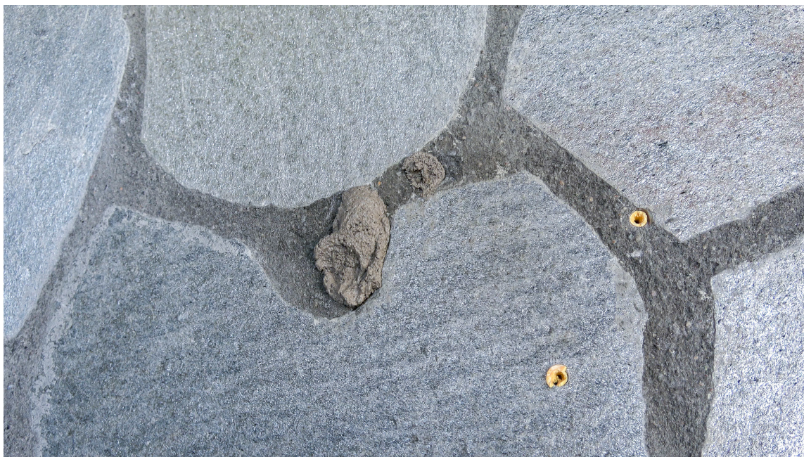
MØRTEL PÅ PATRON: Sprekker og hull etter skruer i skifermuren kan enkelt fikses med mørtel på patron. Dette fungerer som en vanlig fugemasse, og har betonggrå farge.
