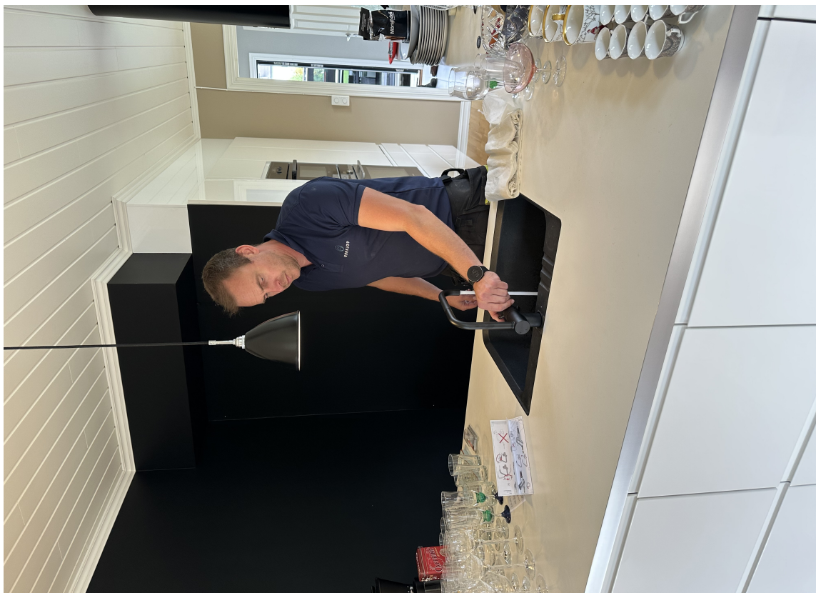
EKSPERTISE: Hvis uhellet er ute og det blir en vannlekkasje, er det trygt å vite at rørleggeren står bak jobben og produktet.
