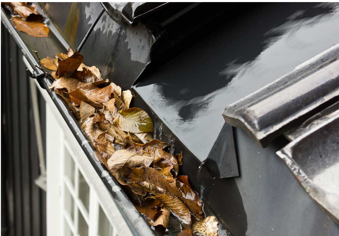
TØM RENNA: En takrenne full av barnåler og løv kan flomme over, eller fryse i stykker.
