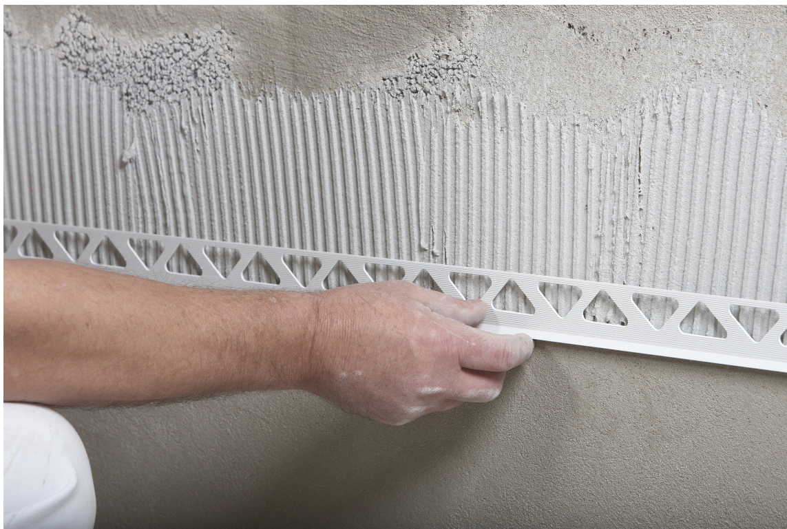
1. På fasader monteres en sokkellist som dryppkant nederst. Denne settes enkelt opp med flislim og forhindrer at vann trekker opp i pussen.
