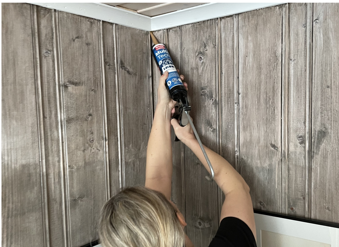
SPREKKER I HJØRNER: Har du panel på veggen, blir det lett sprekker i hjørnene når treverket beveger seg med endret luftfuktighet. Casco MultiTech lager en fleksibel fug, som følger med panelets bevegelser.
