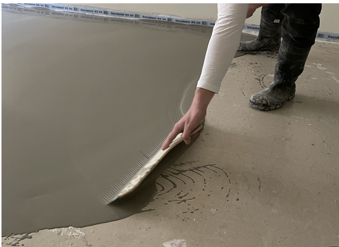
FORDEL MASSEN: Ved hjelp av en tannsparkel fordeles avrettingsmassen ut over gulvet. Du trenger ikke å være veldig nøye, massen flyter godt ut og jevner ut seg selv.
