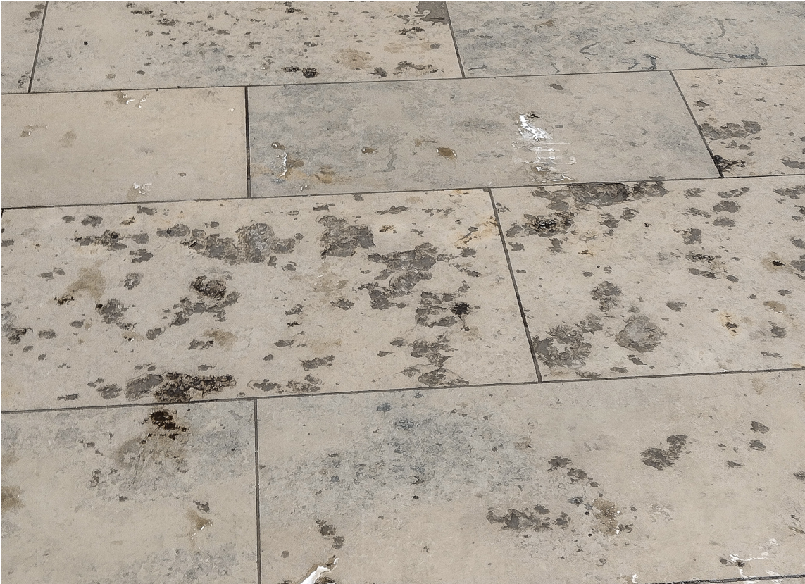
IKKE DIGG MED PIGG: Slik blir gulvene seende ut etter at kunder tramper inn med piggsko. Hull og avflassing. Dette er fra et kjøpesenter i Oslo.
