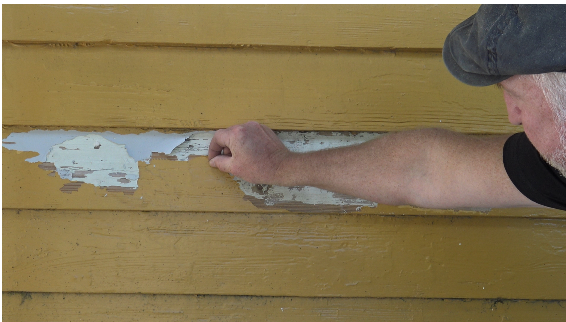
BLÆRING: Kledningen på huset har dårlig vedheft og det dannes blærer i malingfilmen.
