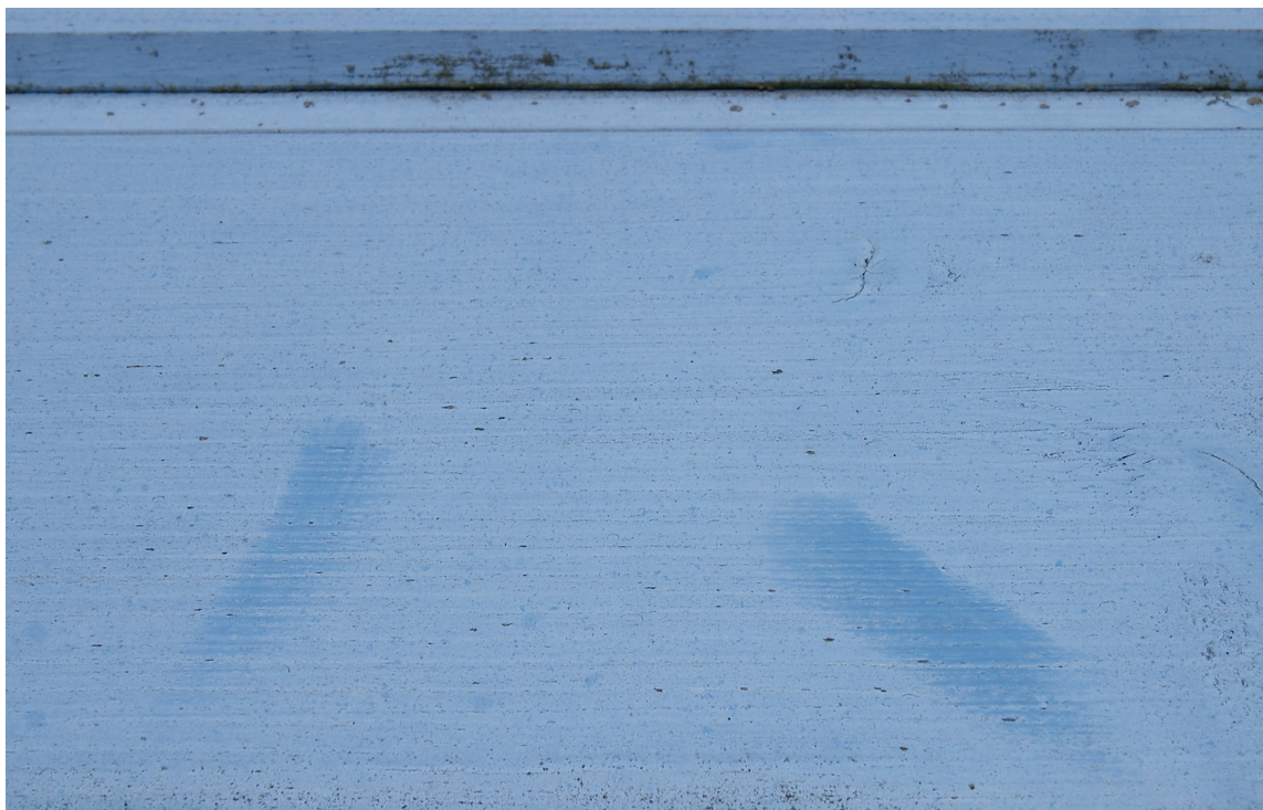
KRITTING: Når fargen fra fasaden smitter over på fingrene ved berøring, heter det at malingen krittet.
