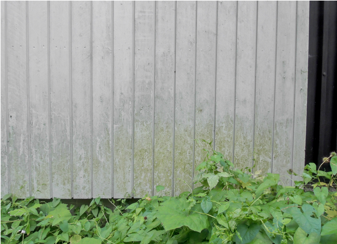
SVERTESOPP OG GRØNSKE: Etter flere år uten en real omgang med vaskekost og rengjøringsmiddel, kan fasaden få kraftig begroing av alger og sopp.
