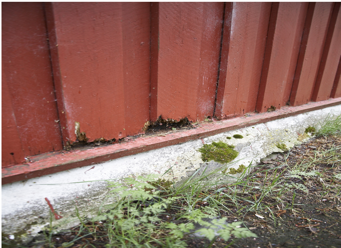
RÅTE: Nederst på kledningen er treverket mest utsatt for fukt. Her kan tegn på råte oppdages på et tidlig tidspunkt.
