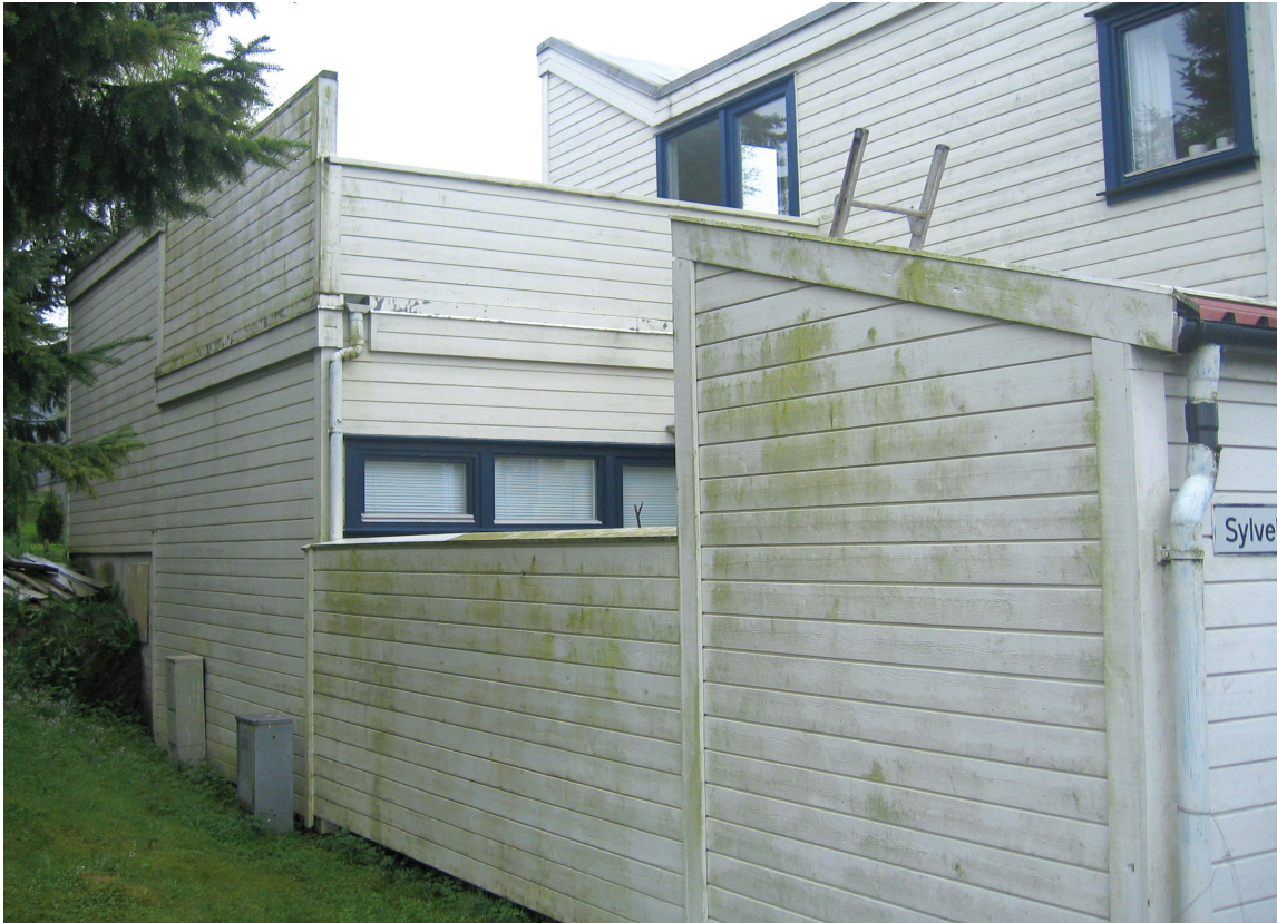
BEGROING: Vegger som tørker sakte og ikke varmes like mye av solen blir ekstra utsatt for begroing.
