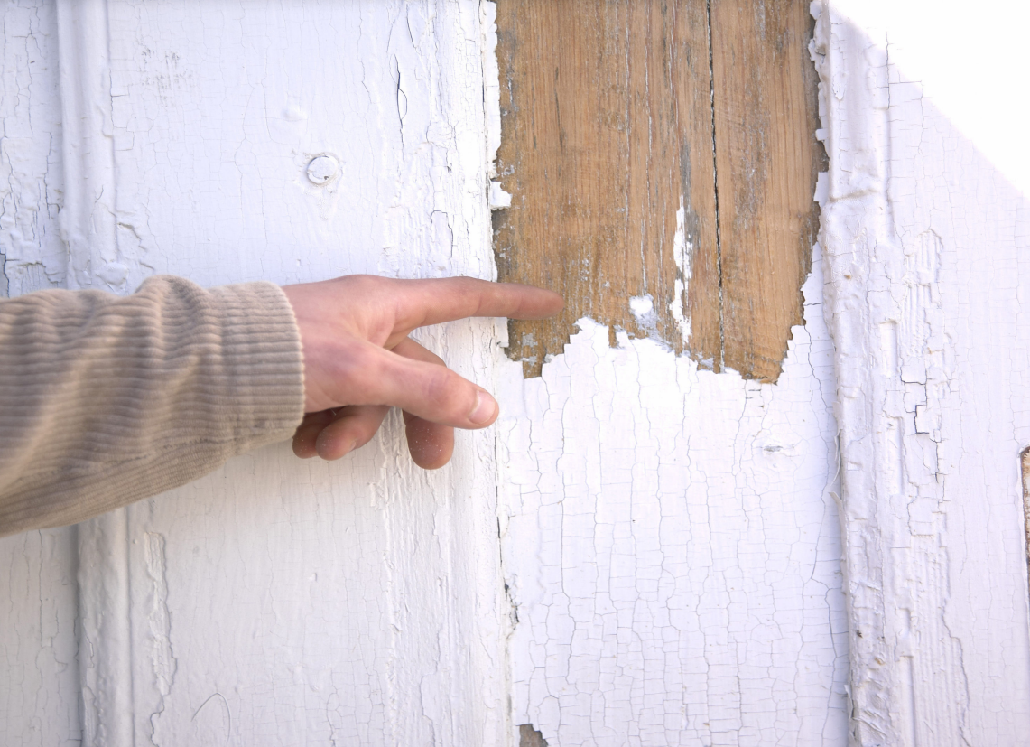
AVSKALLING: Her råder det liten tvil om at fasaden trenger et nytt strøk maling.
