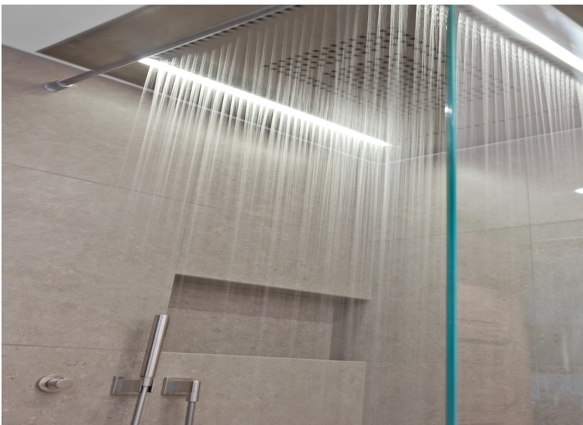
TROPEREGN: Fra den store takdusjen strømmer mengder med mykt vann. I tillegg er dusjnisen utstyrt med to hånddusjer. Sluken er plassert i vegg, istedenfor i gulvet.
