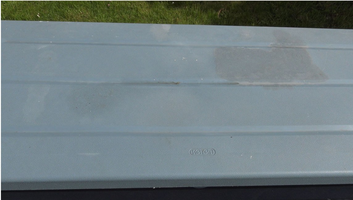
FØR: Full av skjolder.
