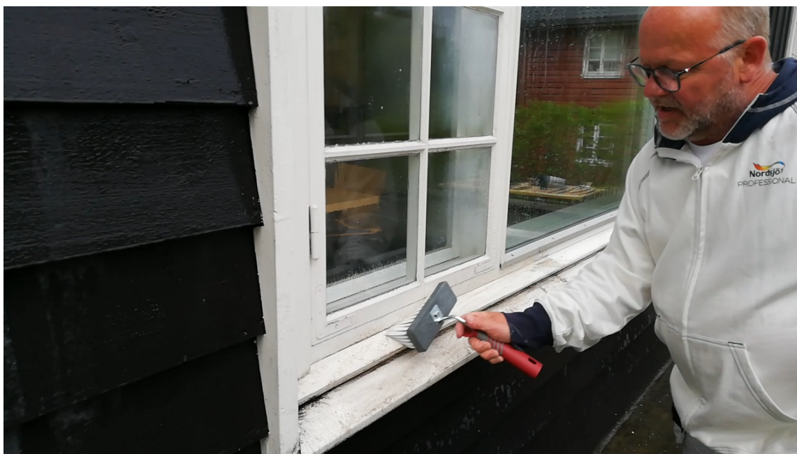
VASK: Start med en grundig vask, det kan skjule seg mye sprekker og løs maling under støv og skitt.
