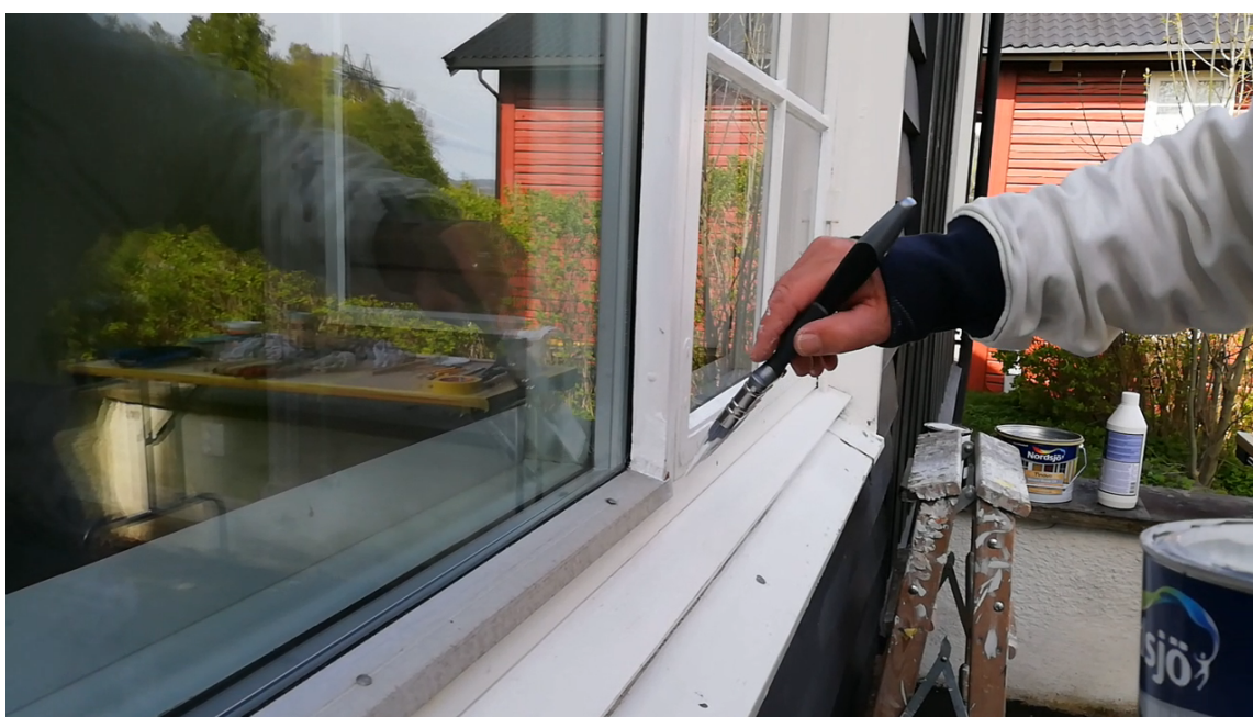
FLEKKE: Når impregneringen er tørr, er vinduet klart for flekkgrunning og senere flekkmaling.
