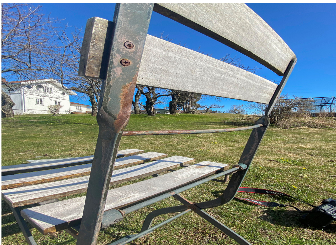
RUSTSKADER: Quick Bengalack Rett på rust har rustbeskyttelse, grunning og toppstrøk i ett.
