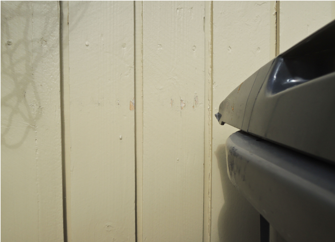
FORT GJORT: Hakk og sår i malingfilmen som har kommet av slag, snømåking eller stabling av ved for eksempel, bør utbedres før skaden vokser seg stor.
