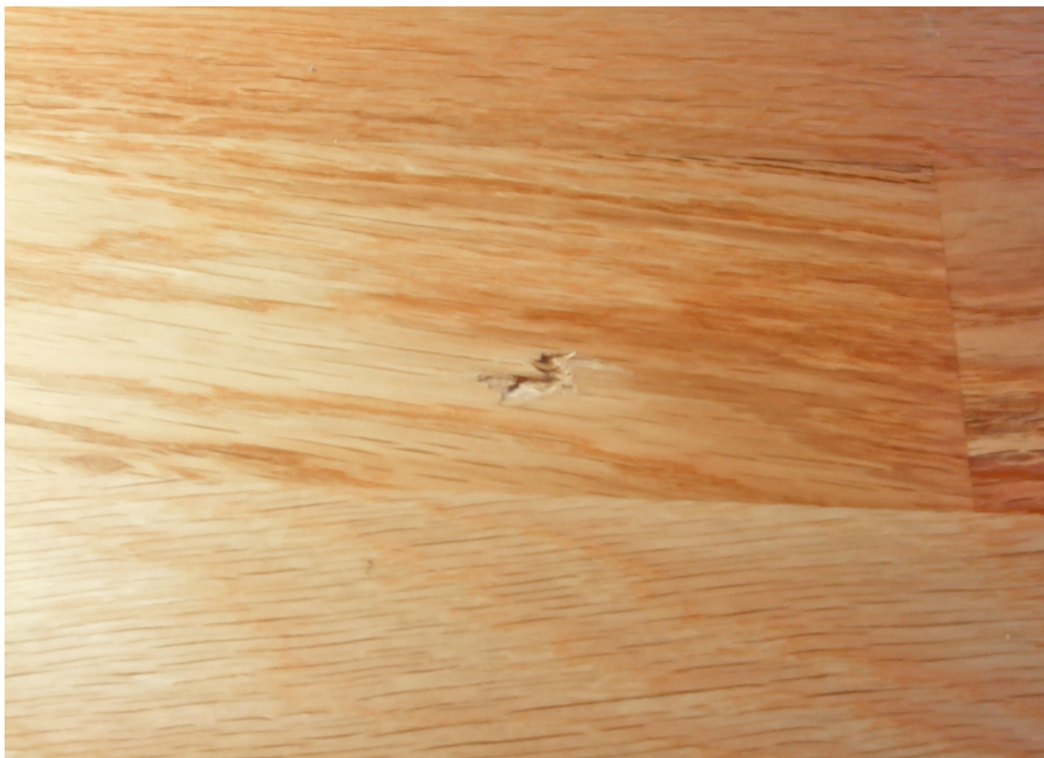
SKADE: Gulvet tåler ikke alt. Da gjelder det å vite hvordan man skal gå fram for å redde det når skaden er ute.
