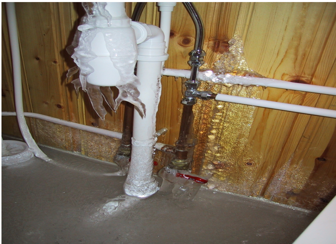
PÅ HYTTA: Det er lite hyggelig å komme tilbake på hytta til synet av frostsprengte rør og store vannskader.
