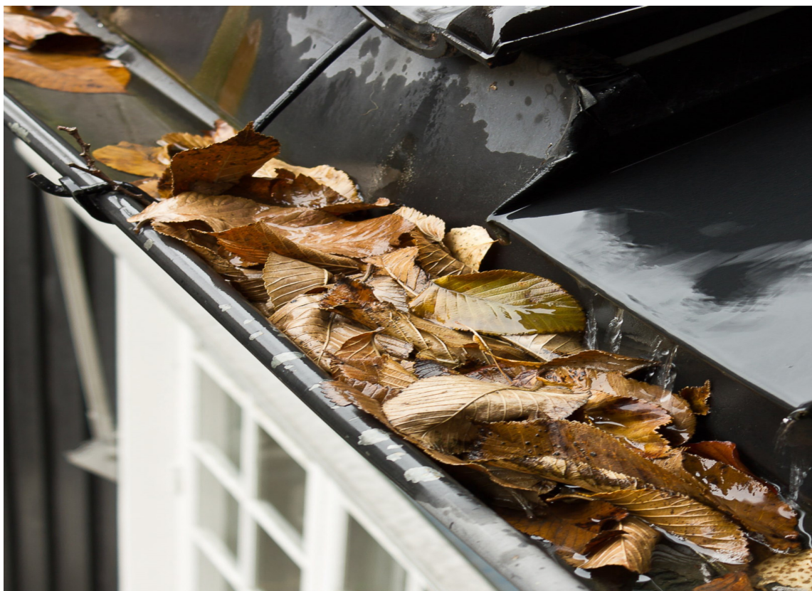
TAKRENNA: Sørg for at takrenna er åpne, slik at det er fri tilgang for vann.
