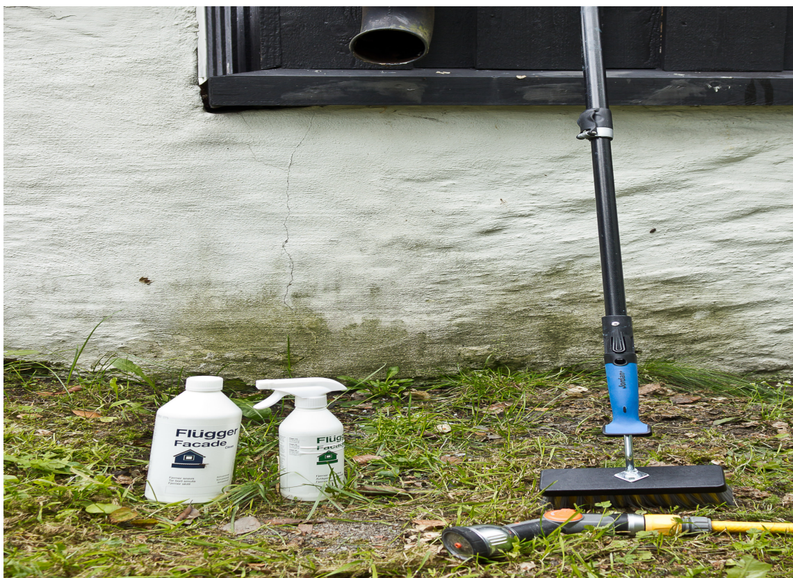
ENKELT: Stygge angrep av smuss og alger er enkelt å fjerne fra både fasade og grunnmur.
