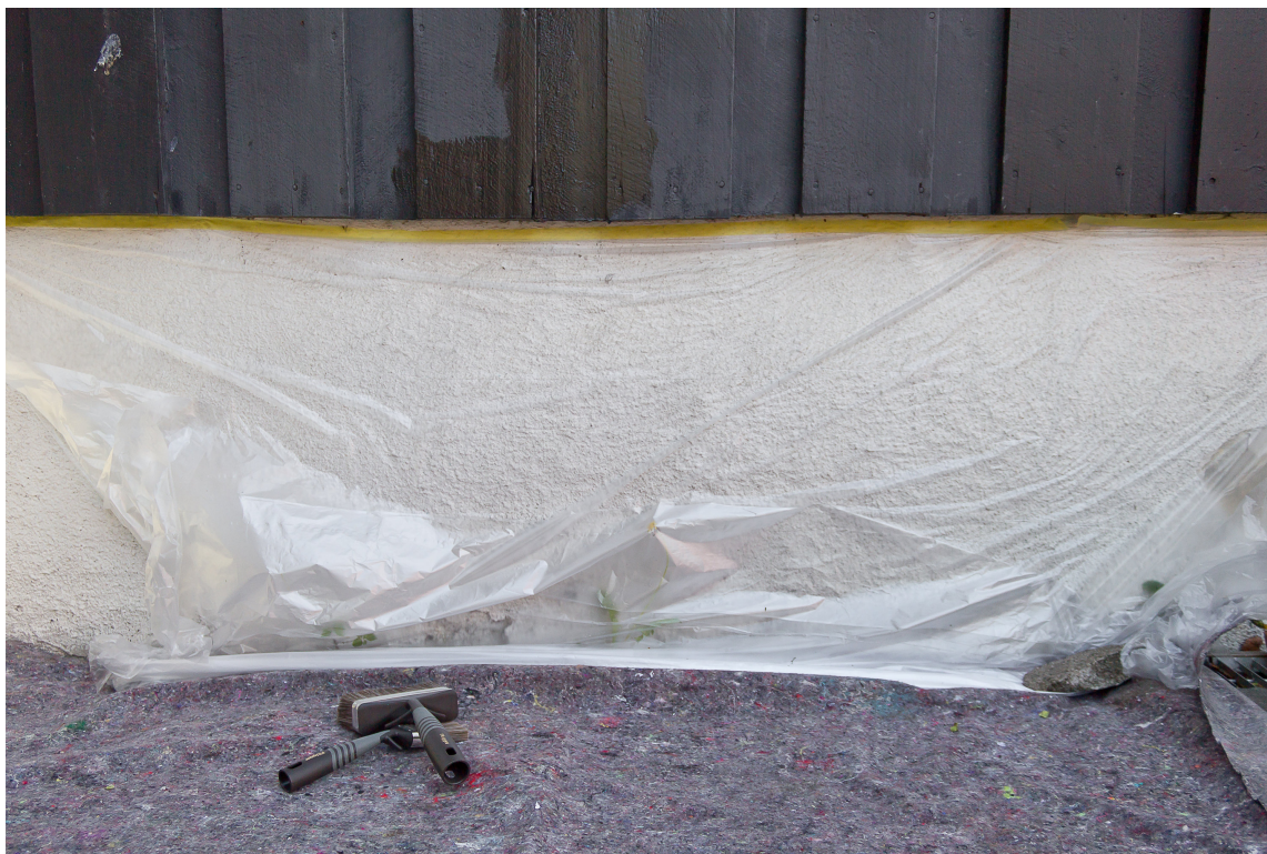
TILDEKKET: En plastfolie beskytter grunnmuren mot malingsøl, og med dekkefilt på bakken unngår du søl på plattinger og asfalt.
