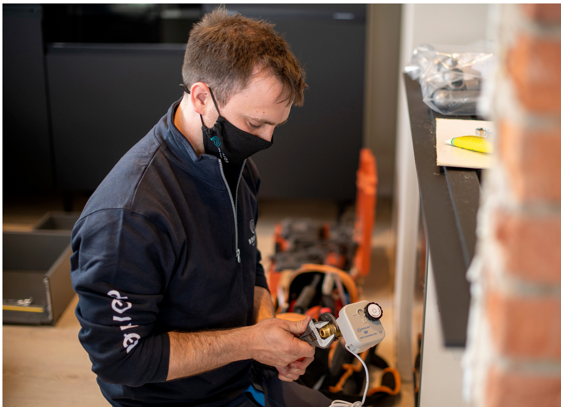
VANNSTOPPER: Med en automatisk vannstoppekran har du god sikring mot vannskader. Her monterer rørleggeren en vannstopper fra O. Berge og Rørkjøp.
