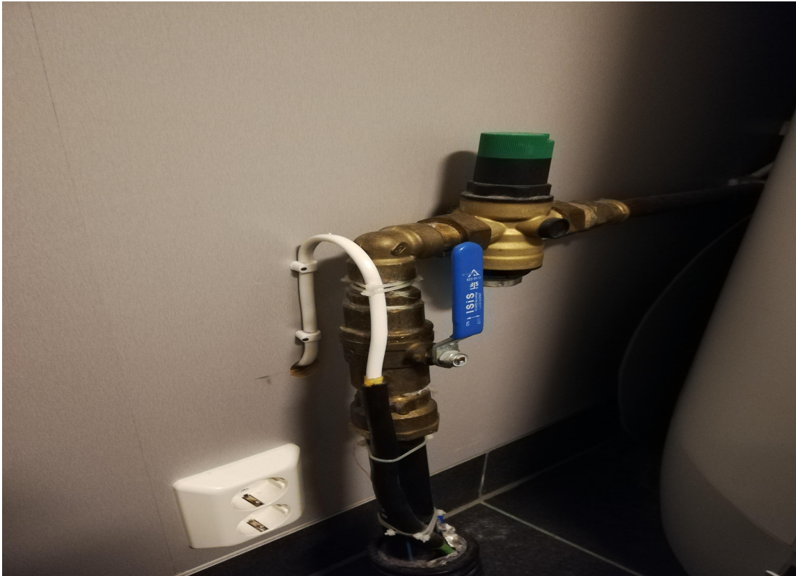
HVOR? Her er krana montert ved siden av varmtvannsberederen.
