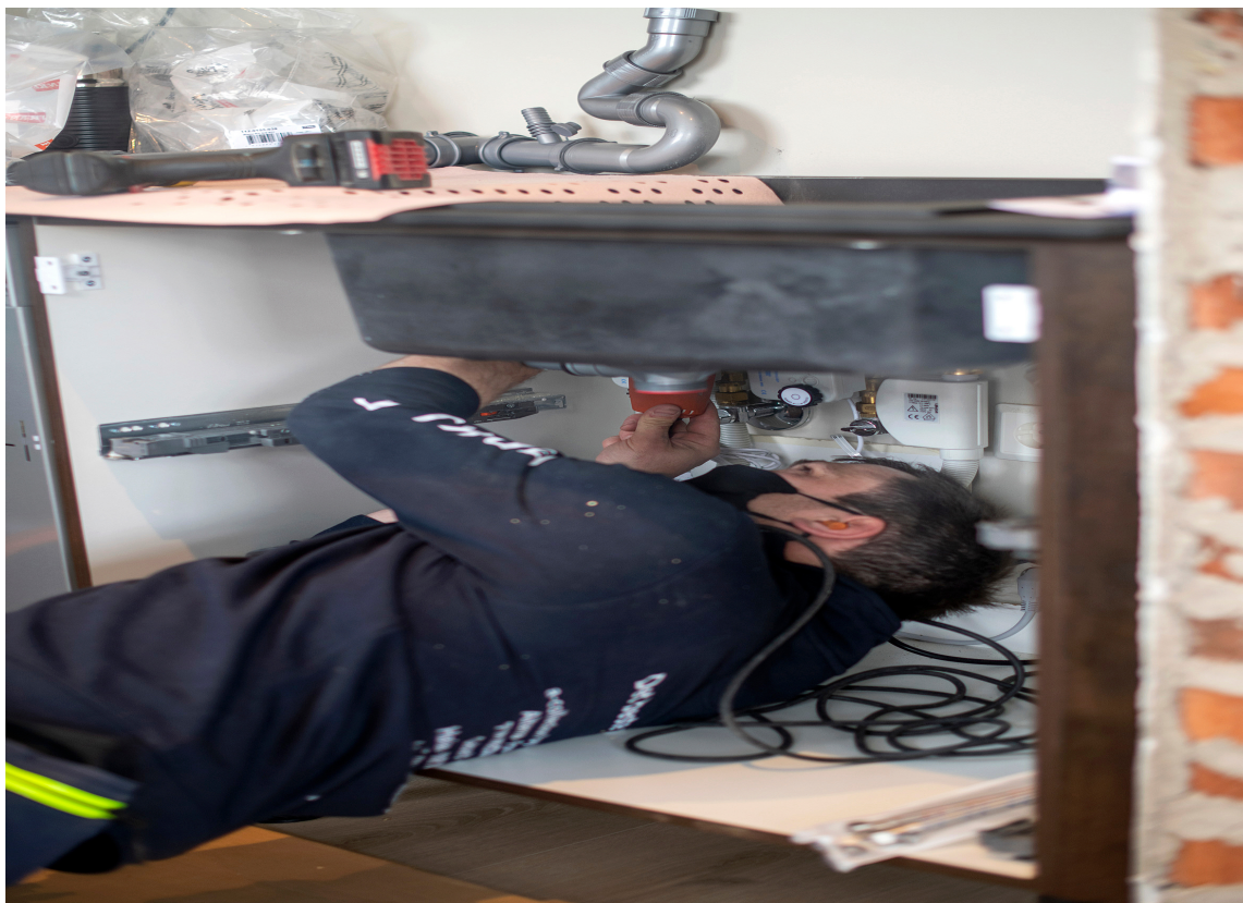
RING: Det lønner seg å få en fagmann til å se over vann- og avløpsinstallasjonene i boligen.
