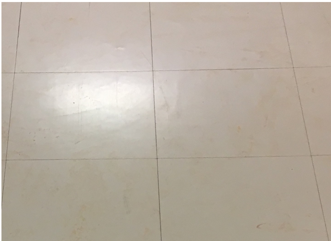
BELEGG: Fra dette belegg kommer det hvitt støv under kontorstolene.
