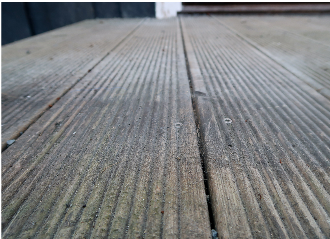
MØKKETE: Slik så trappa ut etter flere år av manglende rengjøring.
