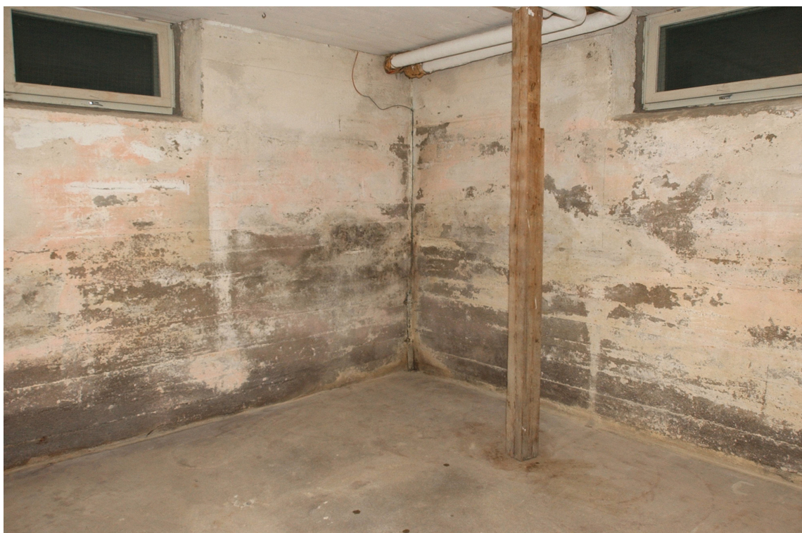
KJELLER: Sviktende drenering av kjellervegger og -gulv kan føre til at fukt trenger inn gjennom betongen.
