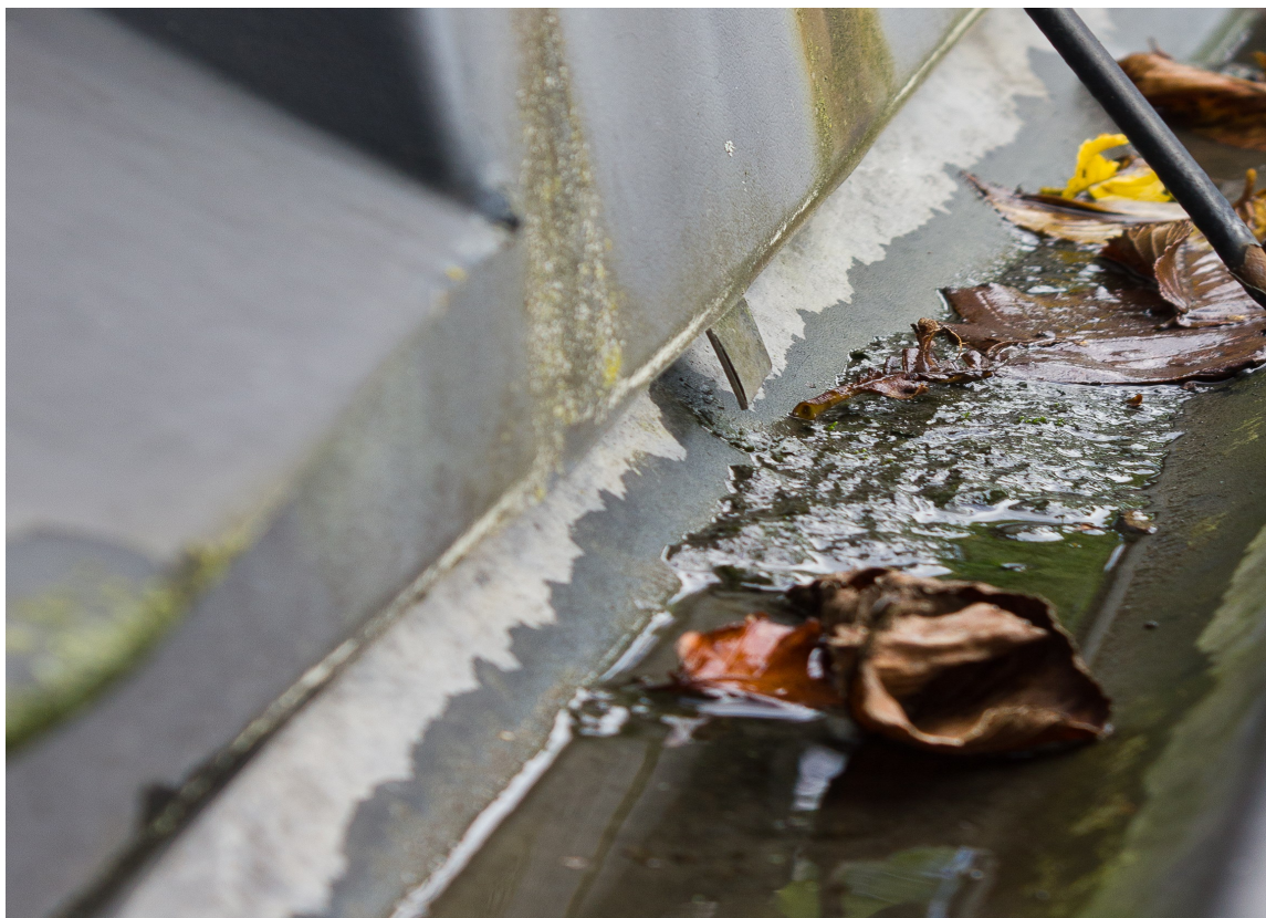
BEGROING: Takrenner og tak er også utsatt for begroing.
