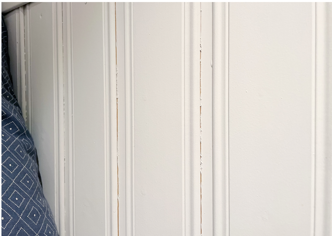
KRYMPESPREKKER: Sjenerende sprekker som oppstår når panelet trekker seg sammen, og malingen ikke følger etter.
