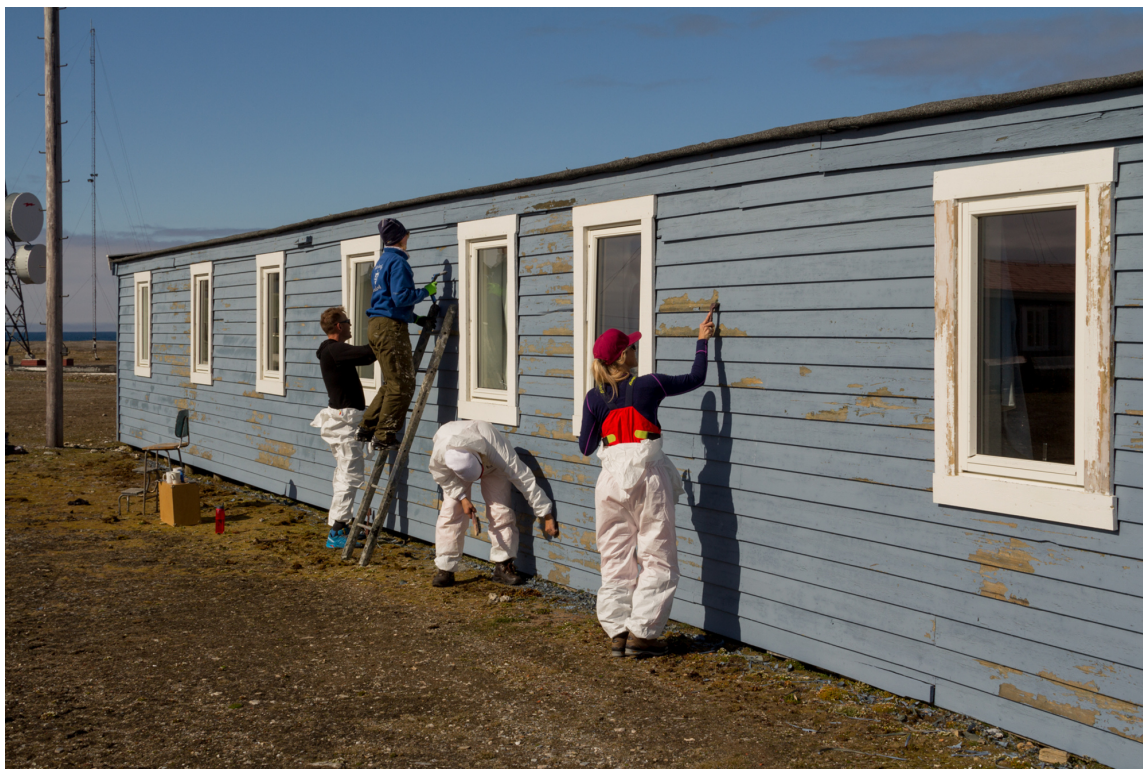
HARDT ARBEID: Dugnadsarbeiderne fikk slite hardt. Alle trefasader ble systembehandlet med malinger fra Nordsjö; impregnering, grunningsmaling og hurtigtørkende av beste kvalitet toppstrøksmaling. (Foto: Mats Nilsson/Nordsjö)
