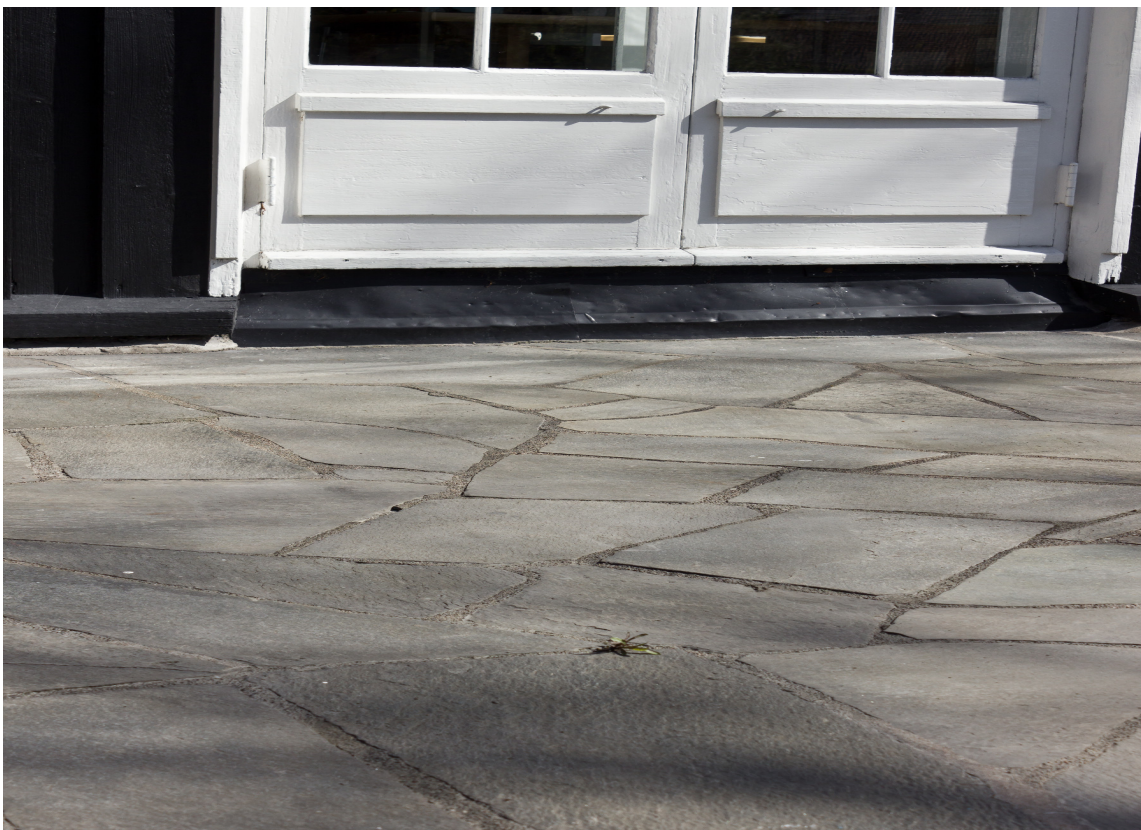
USTELT: Terrassen var helt matt og grå av skitt og støv, og på overtid med tanke på vedlikehold.
