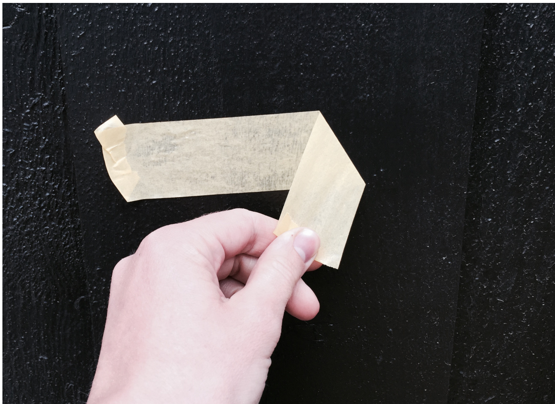
VEDHEFTTEST: Når det ytterste malingsjiktet har dårlig vedheft til underlaget, flasser malingen. Skjult dårlig vedheft testes med et stykke tape. (Foto: Åshild Nyhus Tyssen/ifi.no)
