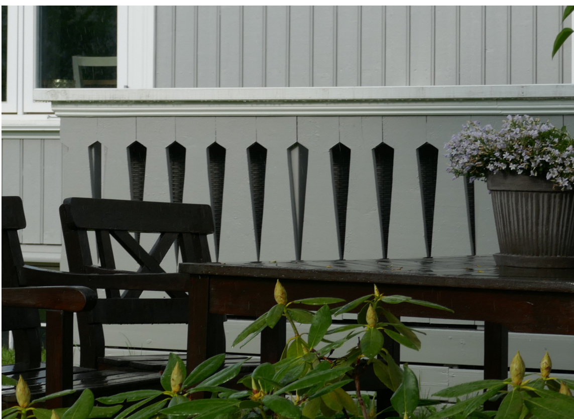
REGN: Etter et regnskyll blir vannet liggende og trenger inn i treverket der det måtte være en åpning. (Foto: Bjørg Owren/ifi.no)
