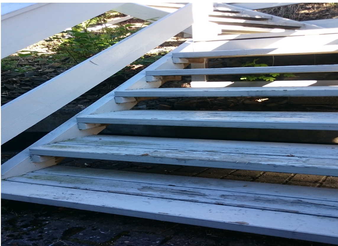
UTFORDRING: Levetiden er kort på dekkende behandling på liggende treverk ute. (Foto: Bjørg Owren/ifi.no)
