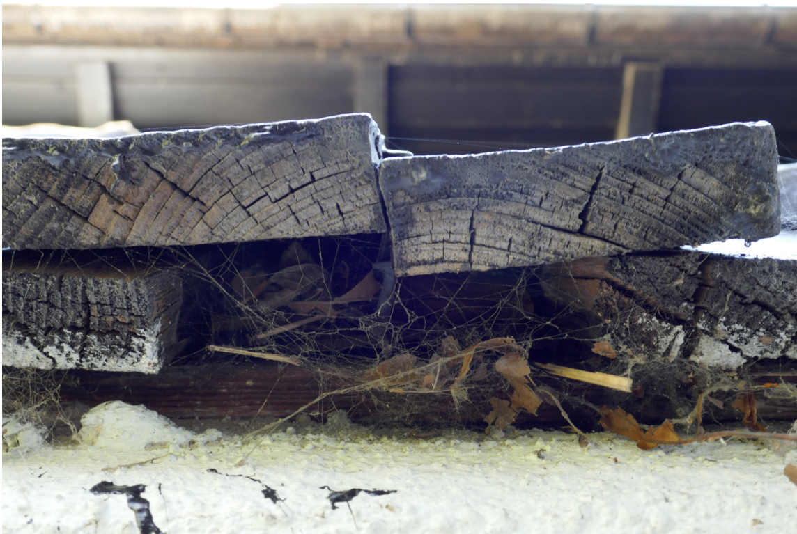
SJEKK: Uffda, her er det slurvet. Tørr og sprukken endeved gir godt krypinn for fukt. (Foto: Mari Rosenberg/ifi.no)
