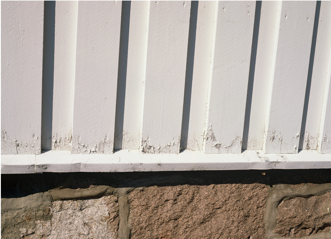
UFFDA: Her står kledningen helt ned på et vannbrett med blikkeslag. Da går det ille med tre og maling. (Foto: ifi.no)
