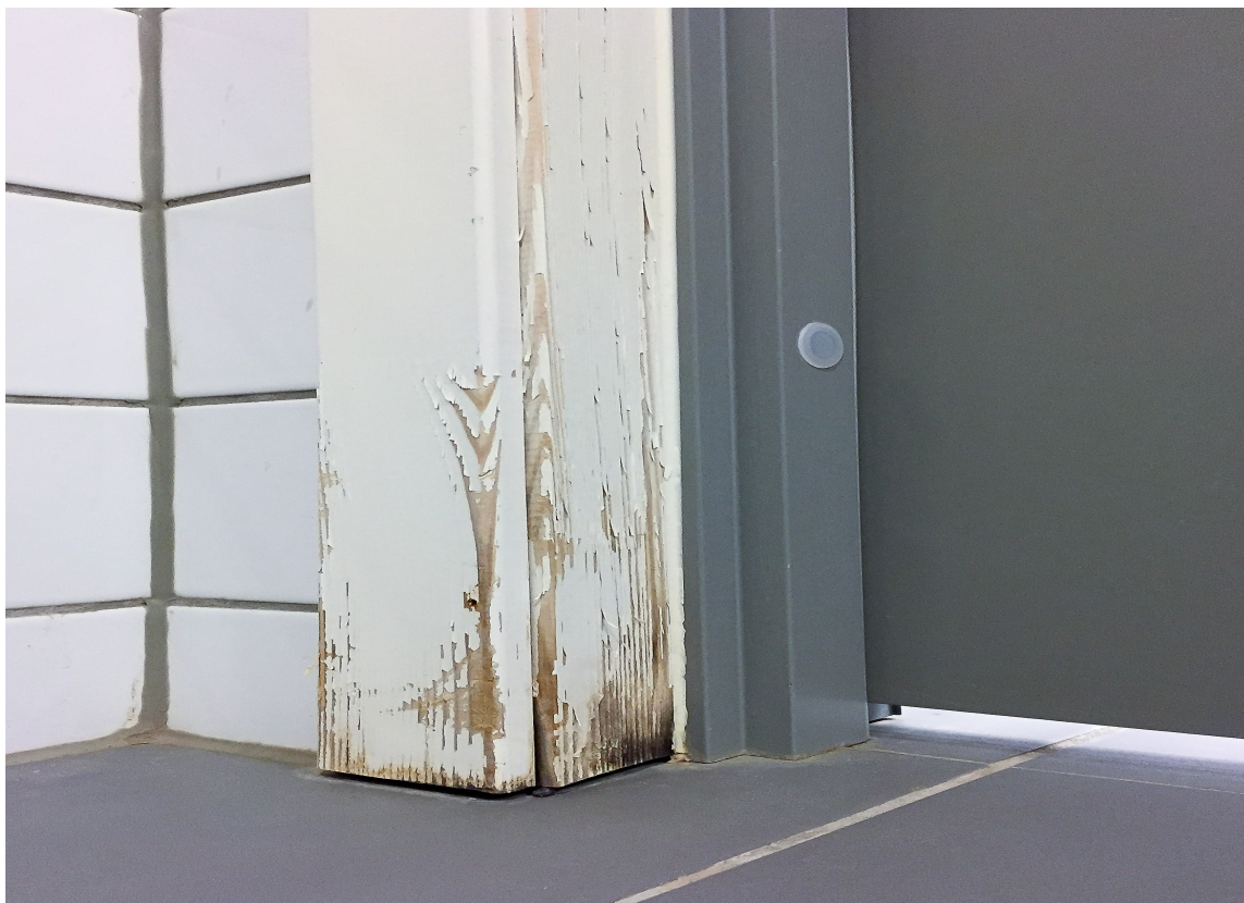
DÅRLIG: Listverk i tre vil etterhvert begynne å flasse og råtne hvis det utsettes for mye vann. (Foto: Chera Westman/ifi.no)
