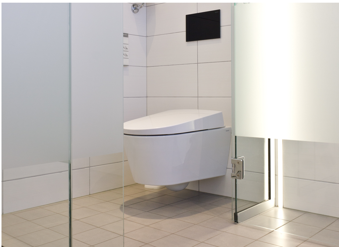
LUKSUS PÅ DO: Toalettene «Rolls Royce» er et dusjtoalett fra Geberit. Det finnes på Olavsgaard hotell utenfor Oslo. Her kan du sette deg ned og la dusjen gjøre deg ren. (Foto: Mari Rosenberg/ifi.no)
