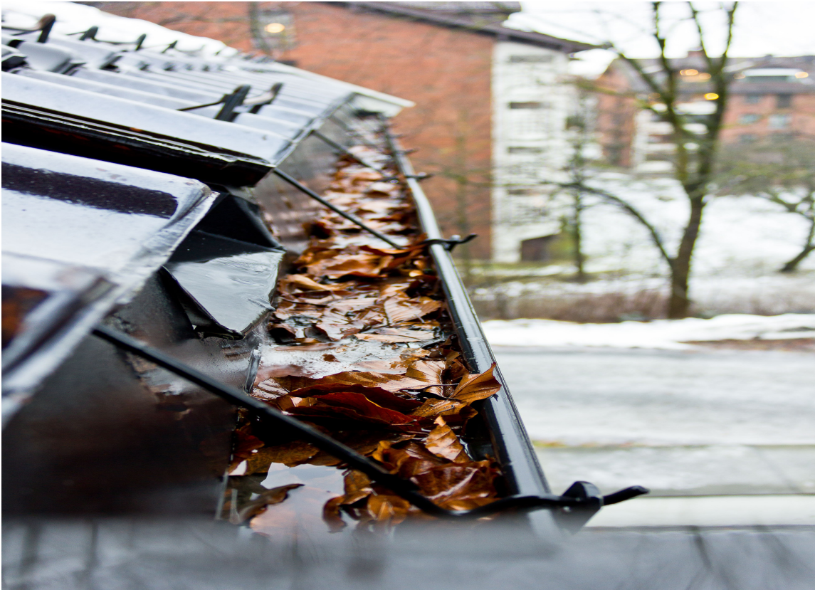
TAR TAK: Løv og skit som har lagt seg utendørs kan være synderen bak utvendige vannskader. (Foto: Chera Westman/ifi.no)
