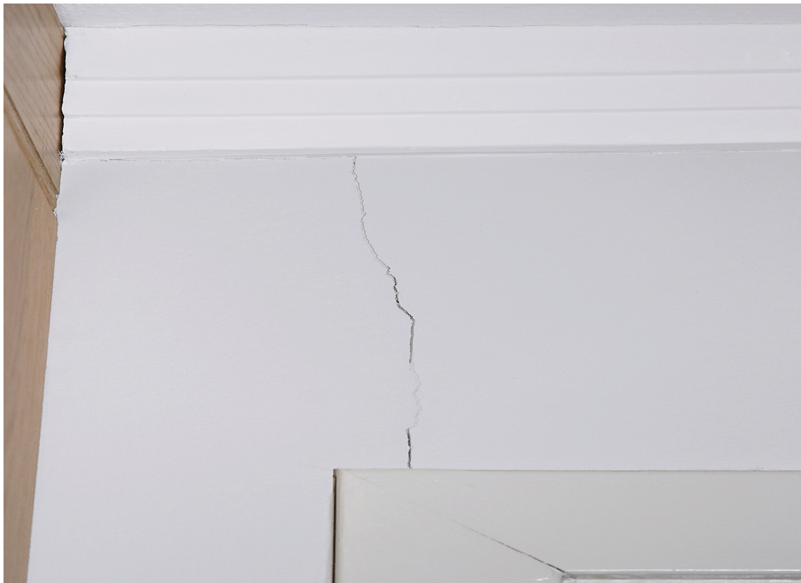
SPREKKER: De fleste hus «lever», uansett hvor gamle de er. Særlig trekonstruksjoner har en tendens til å utvide og trekke seg sammen, alt etter temperatur og luftfuktighet. (Foto: Kristian Owren/ifi.no)
